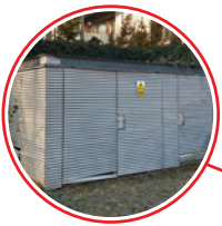
rozdzielnie zewnętrzne i napowietrzne
