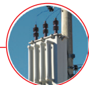
rozdzielnie zewnętrzne i napowietrzne
