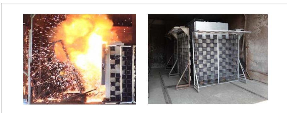
Rys. 1. Rozdzielnica e 2 ALPHA 12 kV, 40 kA podczas prób łukowych oraz przykład nieudanej próby łukowej rys. W. Chmielak
