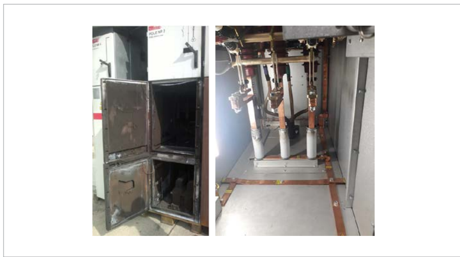
Rys. 5. Widok rozdzielni e²ALPHA po próbach łukowych 31,5 kA, 1 s oraz widok przedziału przyłączeniowego rozdzielni e²ALPHA po zwarcie łukowym i zadziałaniu zabezpieczenia łukoochronnego ARC rys. W. Chmielak
