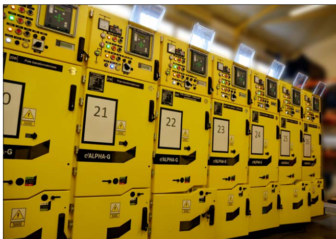
Rozdzielnicę górniczą e 2 ALPHA-G dla KGHM SA (zainstalowana 1200 m pod ziemią)
