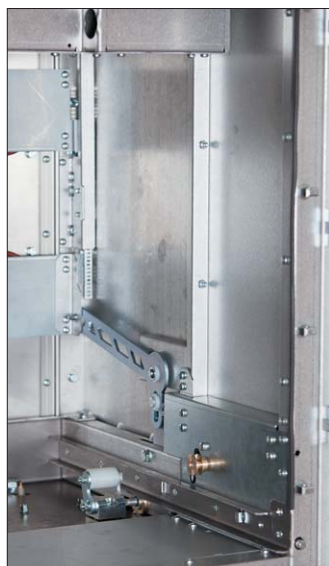
Wnętrze przedziału wyłącznikowego rozdzielnicy z widokiem na zintegrowany moduł blokad
