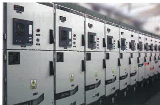
Rozdzielnica jednosystemowa e²ALPHA dla Przedsiębiorstwa Eksploatacji Rurociągów Naftowych
